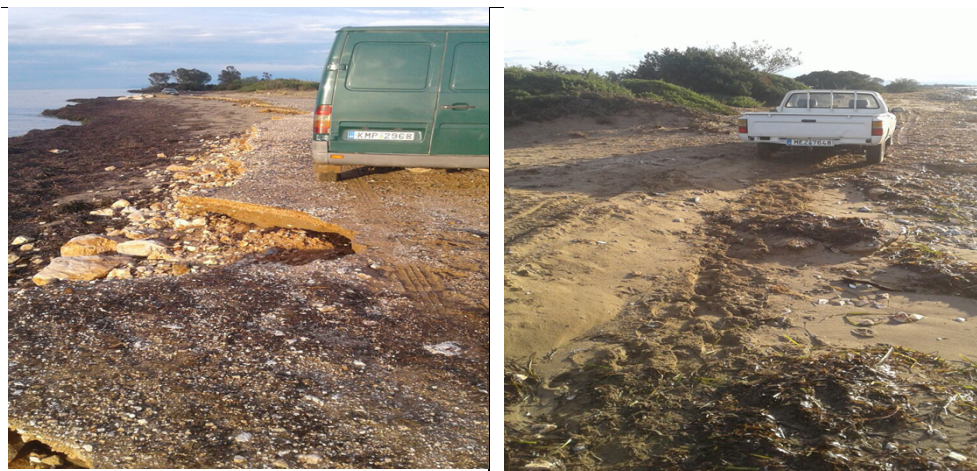
Φωτ. 1. Ζημιές στο δρόμο πρόσβασης προς τη λιμνοθάλασσα Θολής που προκλήθηκαν από τον μεσογειακό κυκλώνα "ΙΑΝΟ" στις 18-9-2020.
