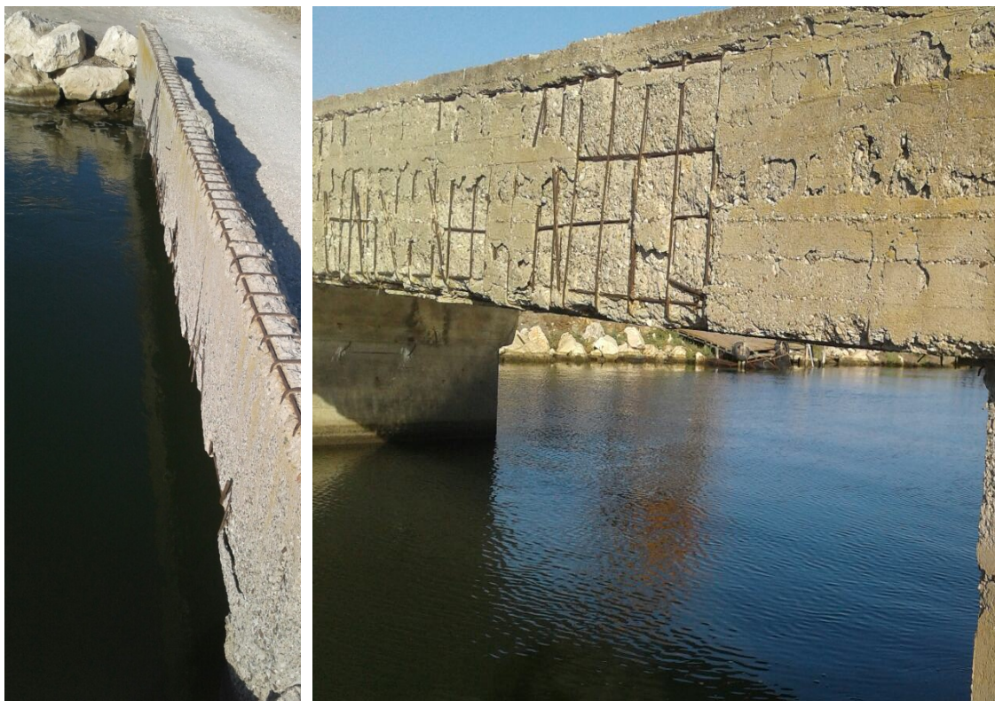
Φωτ. 2. Σημαντικές φθορές στη γέφυρα του ιχθυοτροφείου Θολής που την καθιστούν απροσπέλαστη από οχήματα.
